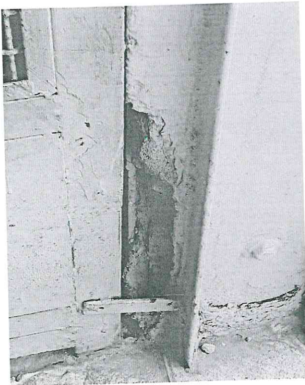
7. Pilar do refeitório – desgaste e ferrugem.
