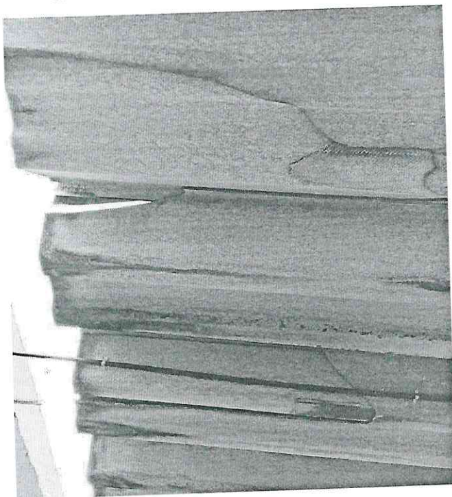
3. Telhado – telhas quebradas e com trincas.
