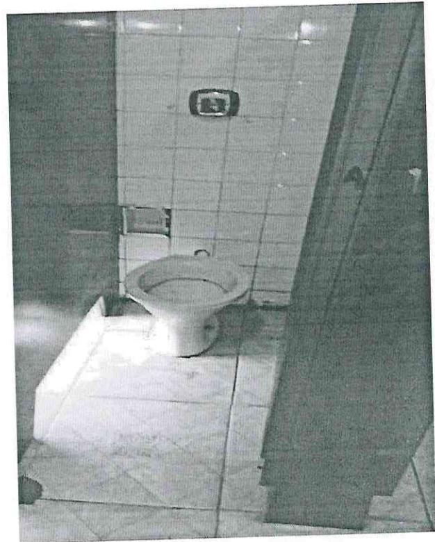
6. Banheiro dos alunos – ausência de válvula de descarga.
