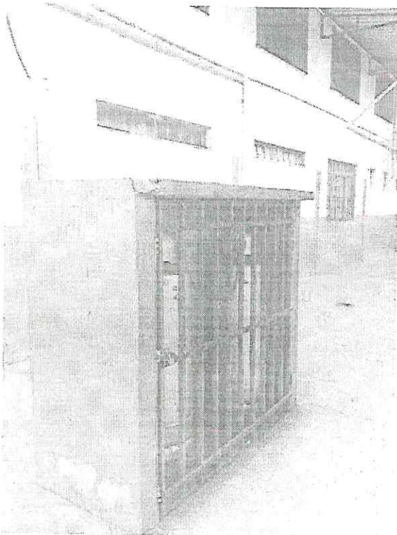
11. Depósito de gás no pátio principal - retirar.
