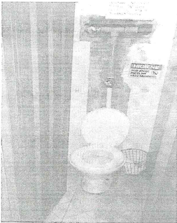
5. Parede do banheiro dos alunos.
