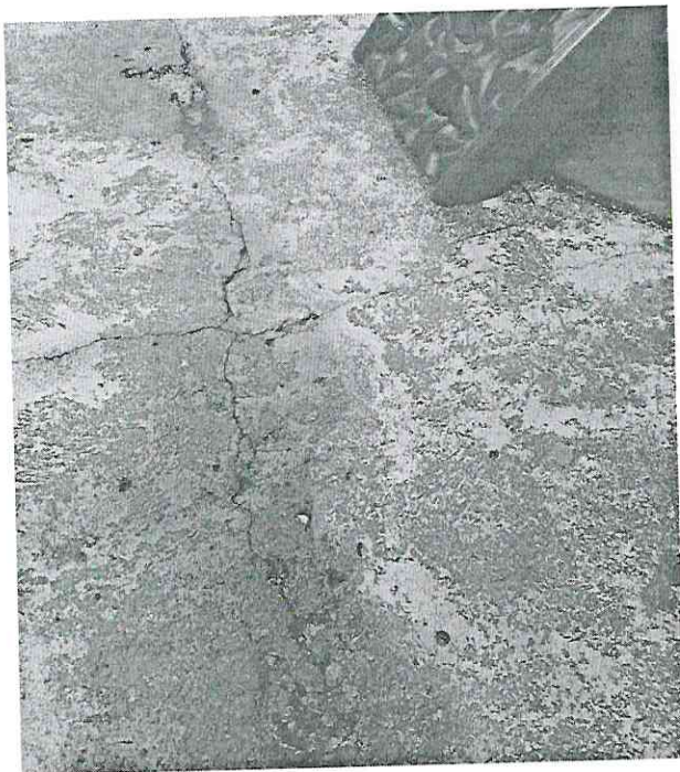
15. Revitalização do piso do Anexo – trincas e buracos.
