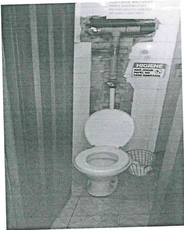
5. Parede do banheiro dos alunos.
