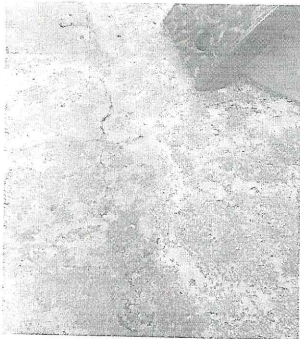
15. Revitalização do piso do Anexo – trincas e buracos.
