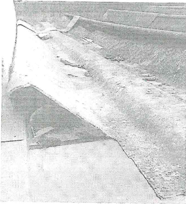
1. Telhado – telhas quebradas.
